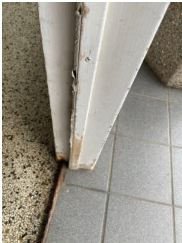
Rusten bundskinne i dør til opgang Blok B
