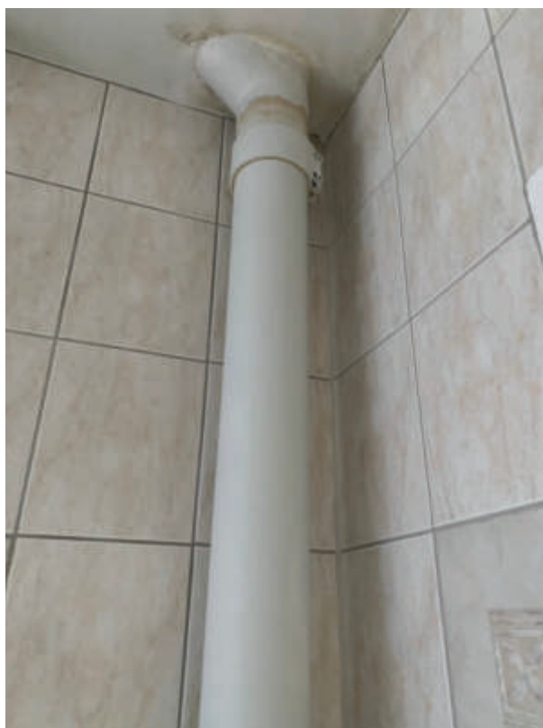
Synlig faldstamme i bolig
