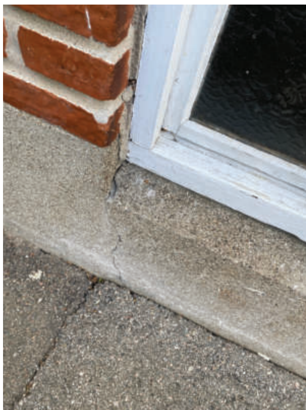
Fugeslip kældervindue Blok A
