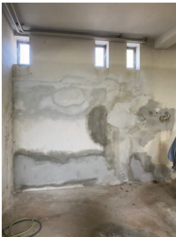
Foto varmekælder Blok A
