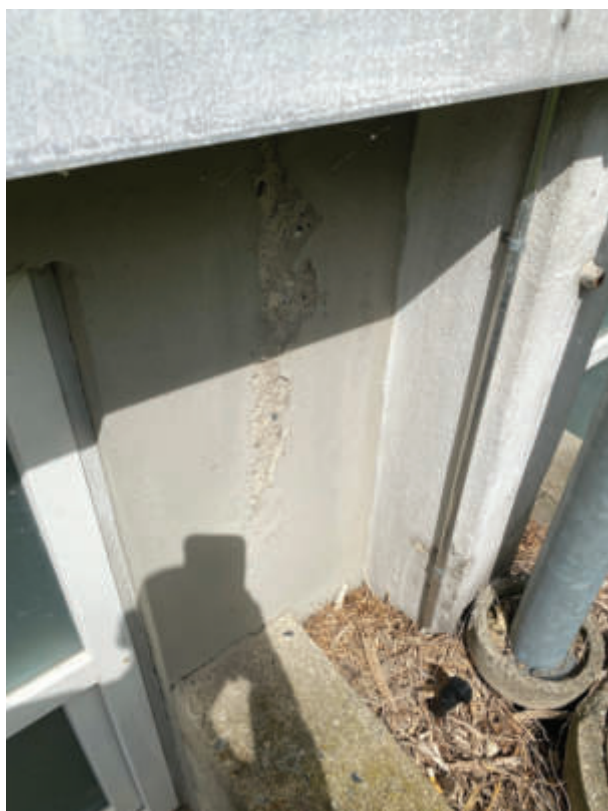
Afskallet puds på sokkel Blok B
