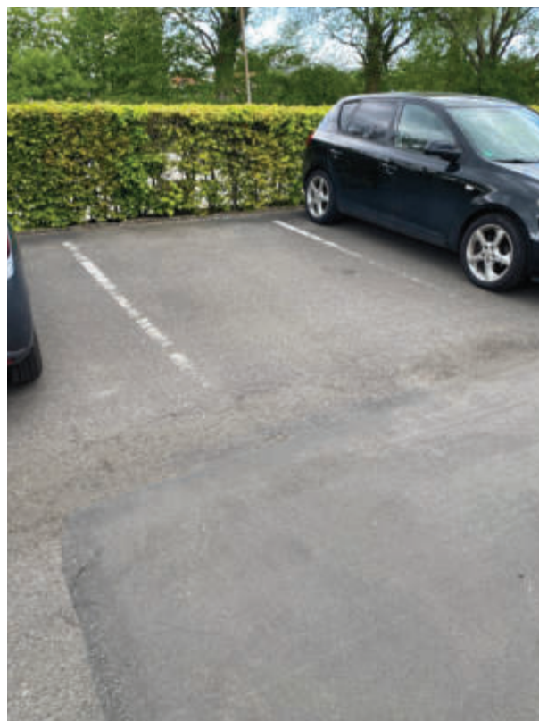
Blok B parkerings opmærkning er slidt
