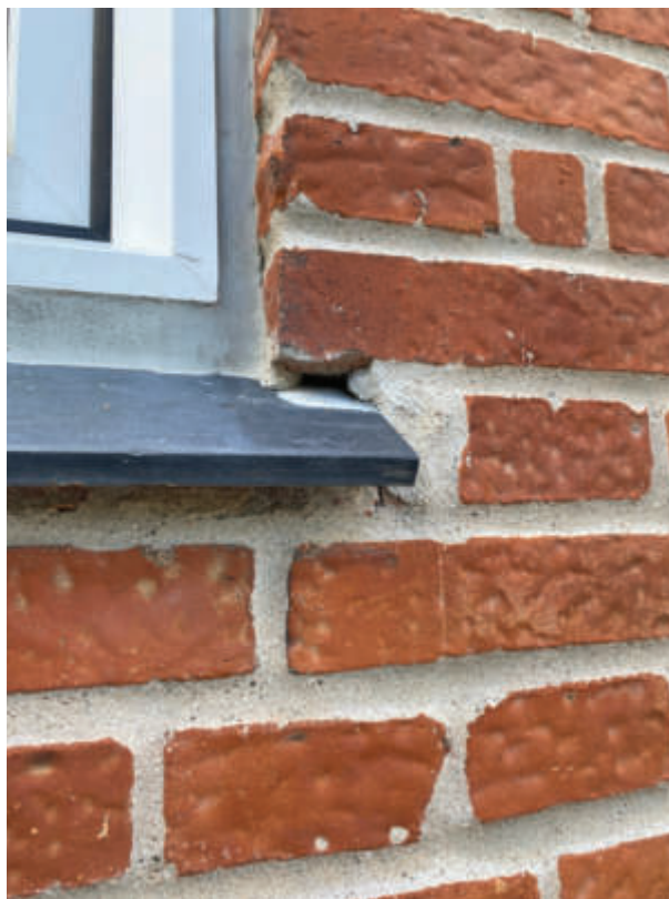
Manglende fuger ved sølbænk Blok A
