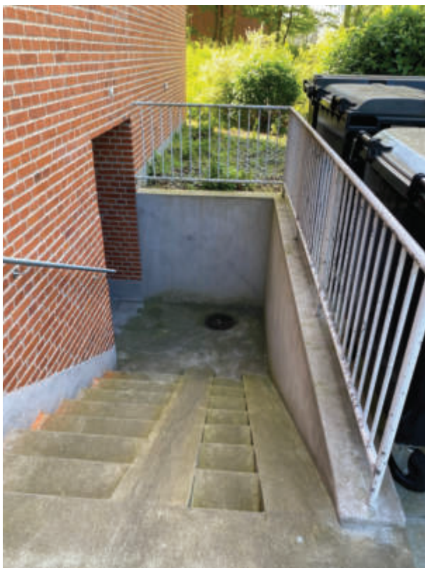
Kældertrappe med algebegrøninger Blok A
