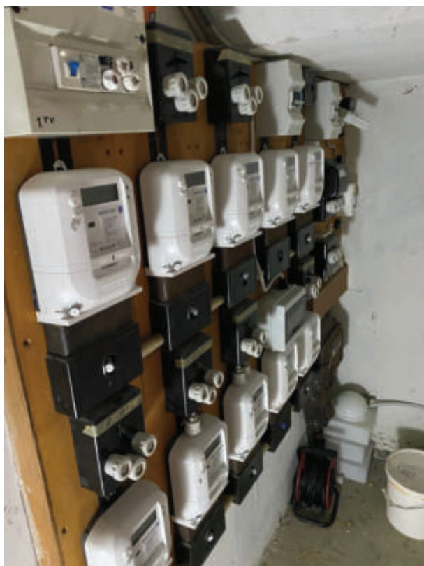
Elmåler i kælder blok B
