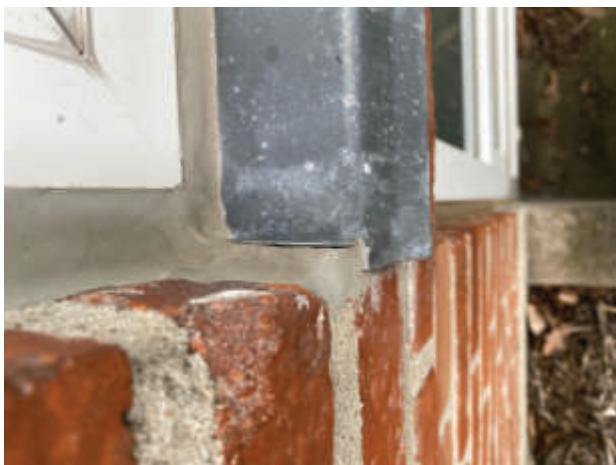
Sålbænke er der fugeslip mod mur Blok A
