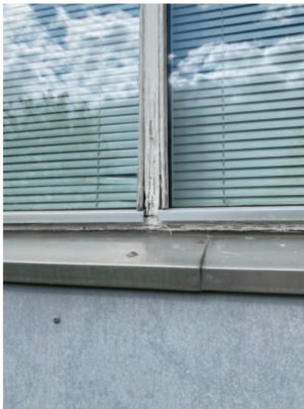
Nedbrudt vindue Blok B
