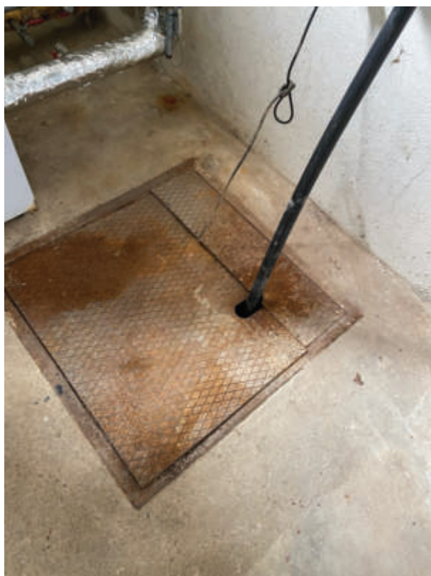
Brønd med dykpumpe
