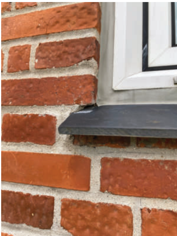
Manglende fuger ved sølbænk Blok A
