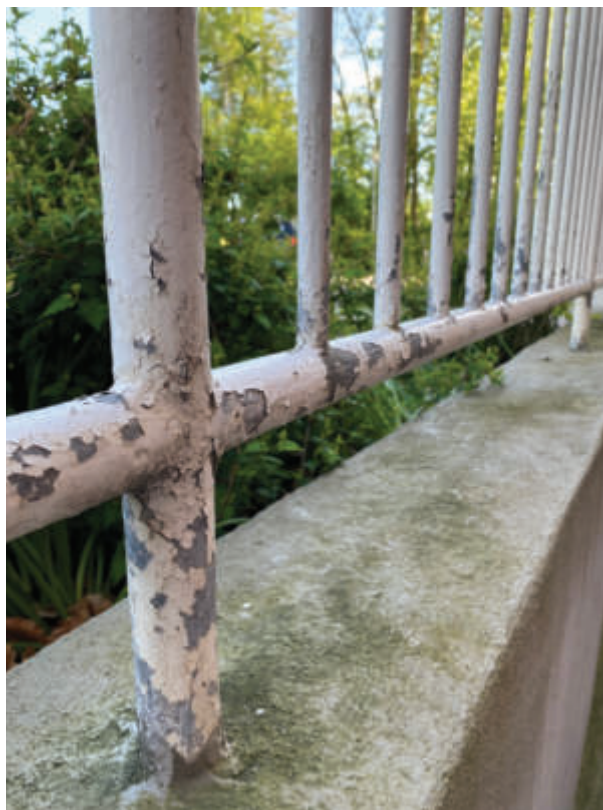
Værn med afskallet maling Blok A
