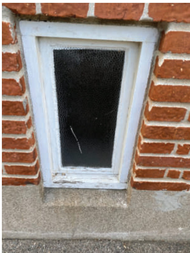
Nedbrudt kældervindue Blok A
