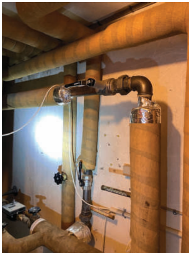
Rør mangler isolering
