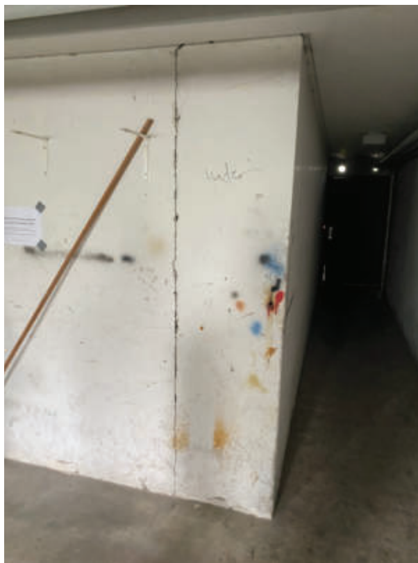
Revne i væg mod garage blok B
