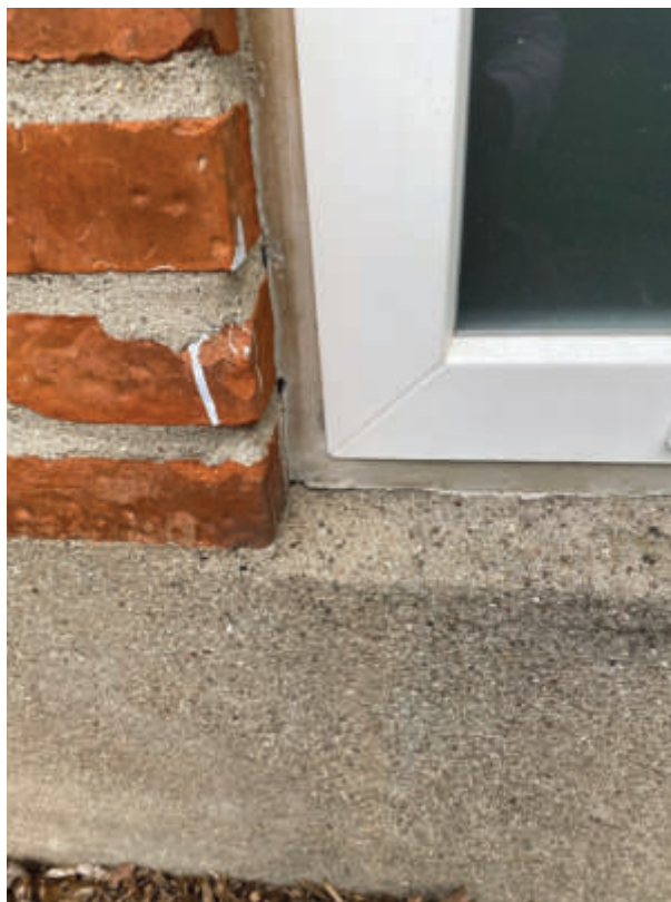
Fugeslip kældervindue Blok A
